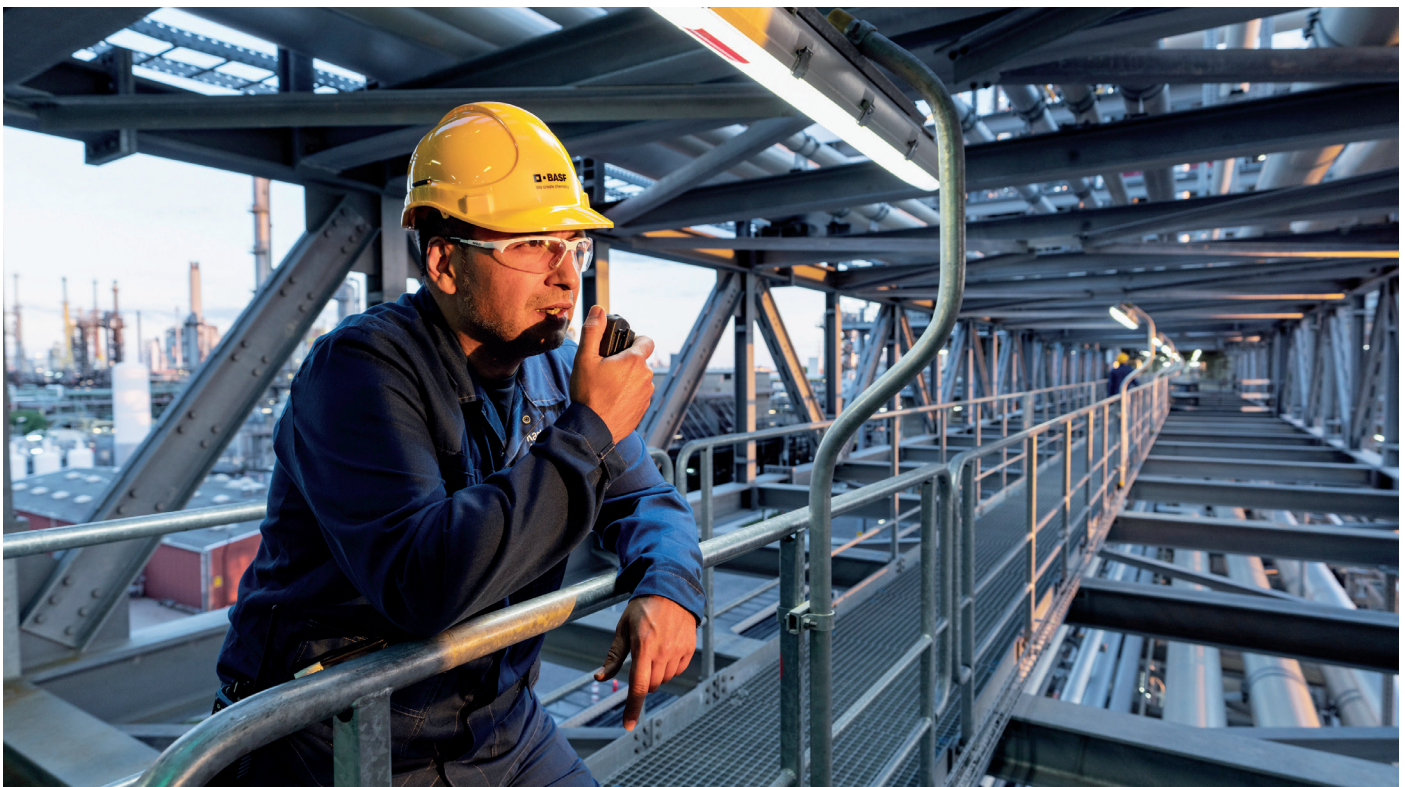
Nueva planta de acetileno en el site de Ludwigshafen.
